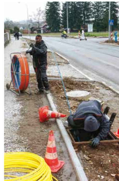
Podzemni kabel u Nazorovoj
