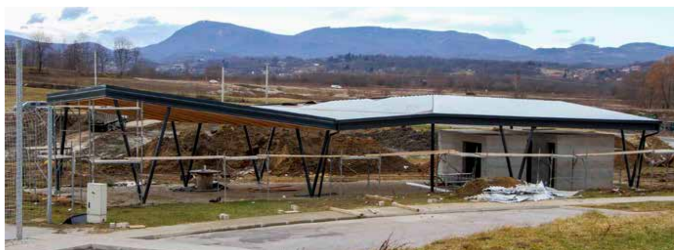
Cijelim prostorom budućeg RC-a dominira atraktivna nadstrešnica, centralno mjesto budućeg druženja sportaša
